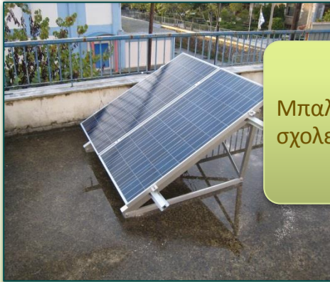
Το Φωτοβολταϊκό πάνελ
